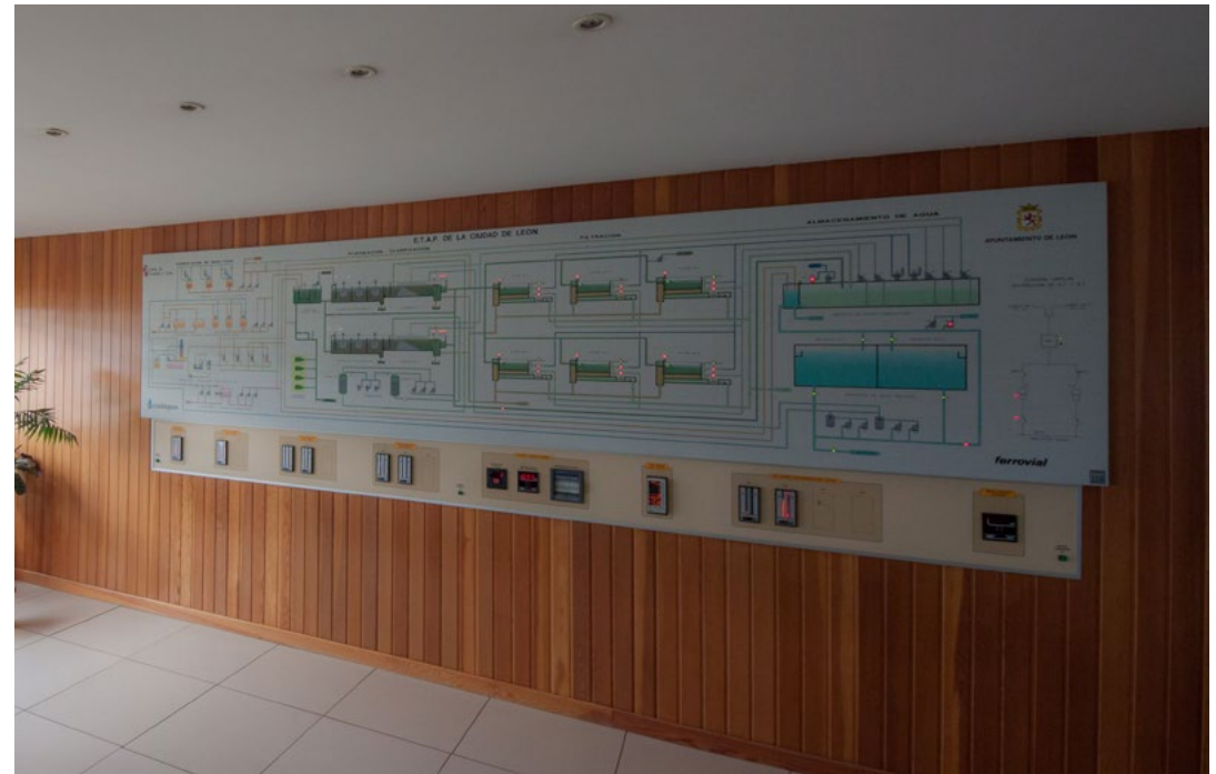
Pantallas de la sala de operaciones de la ETAP del Porma
