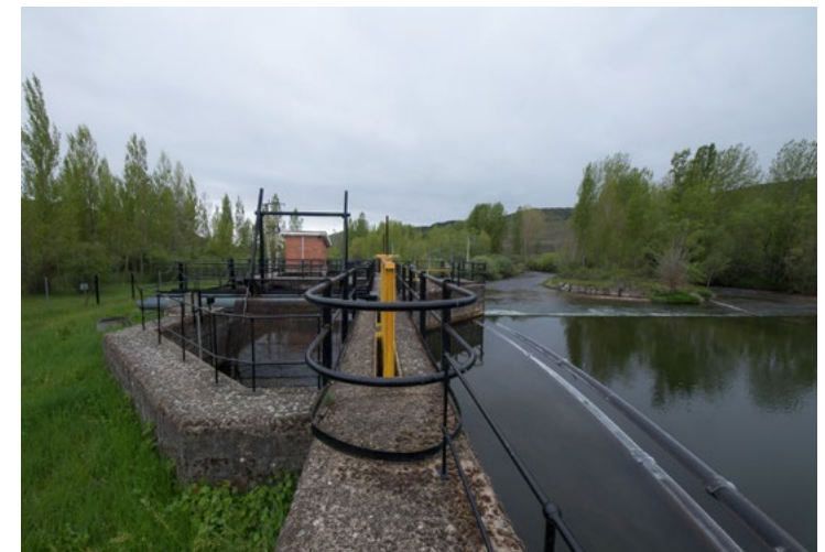
Captación Candanedo de Boñar
