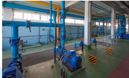
ETAP del Porma
